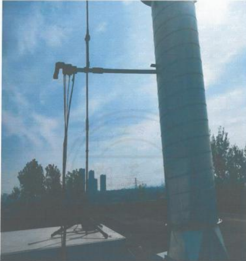
印刷废气、擦拭清洗废气处理装置出口
