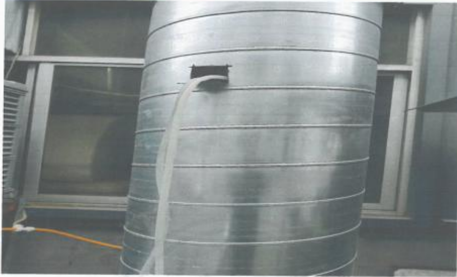
成型废气处理装置进口
