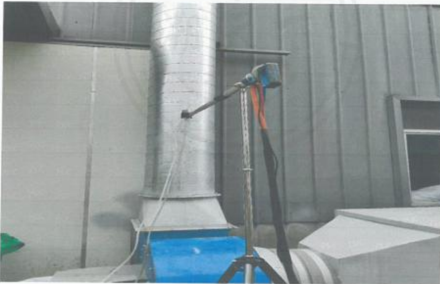
成型废气处理装置出口
