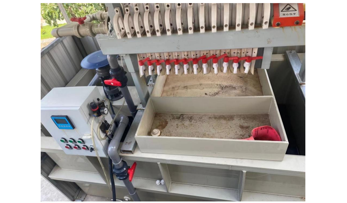
废水收集处理设施
