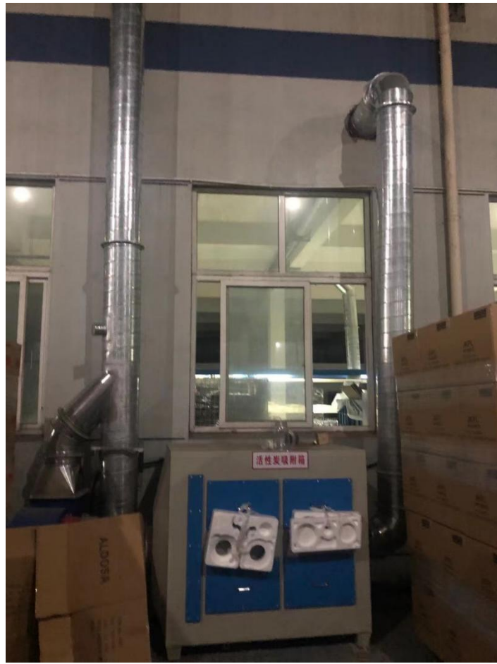
废气收集处理设施
