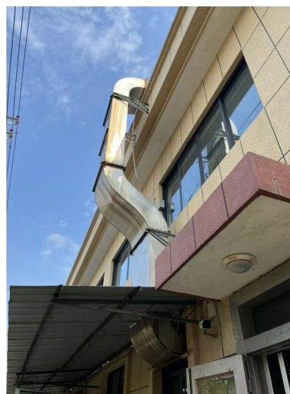
食堂油烟排气筒
