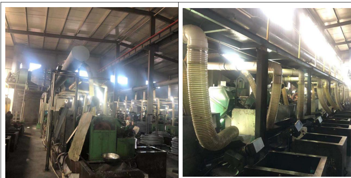
冷镦、搓丝车间及废气收集处理设施
