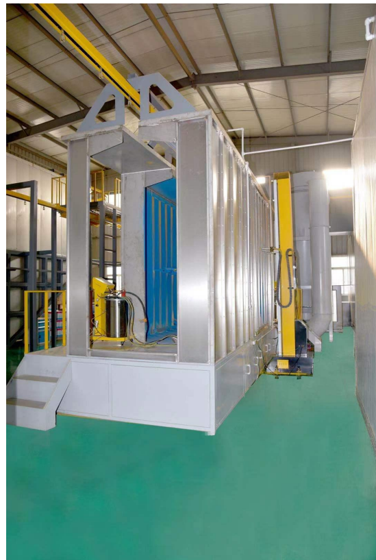
车间、废水及废气处理设备照片
