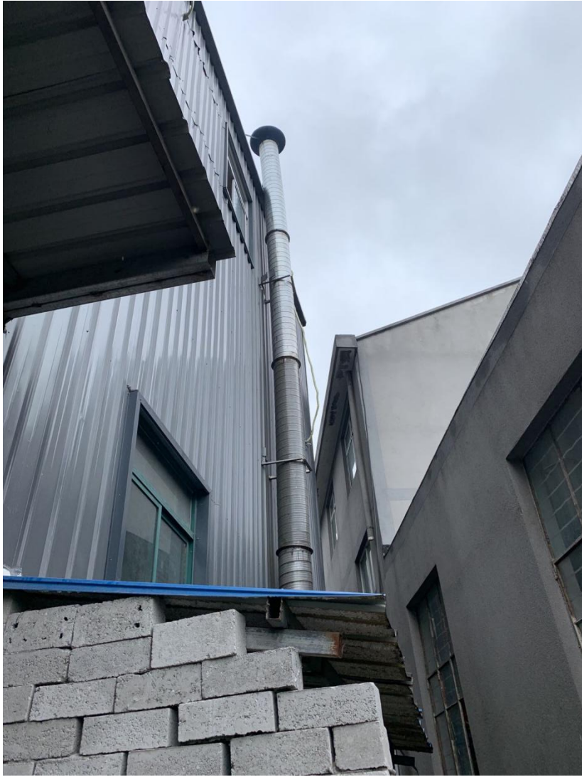
废气处理设备照片
