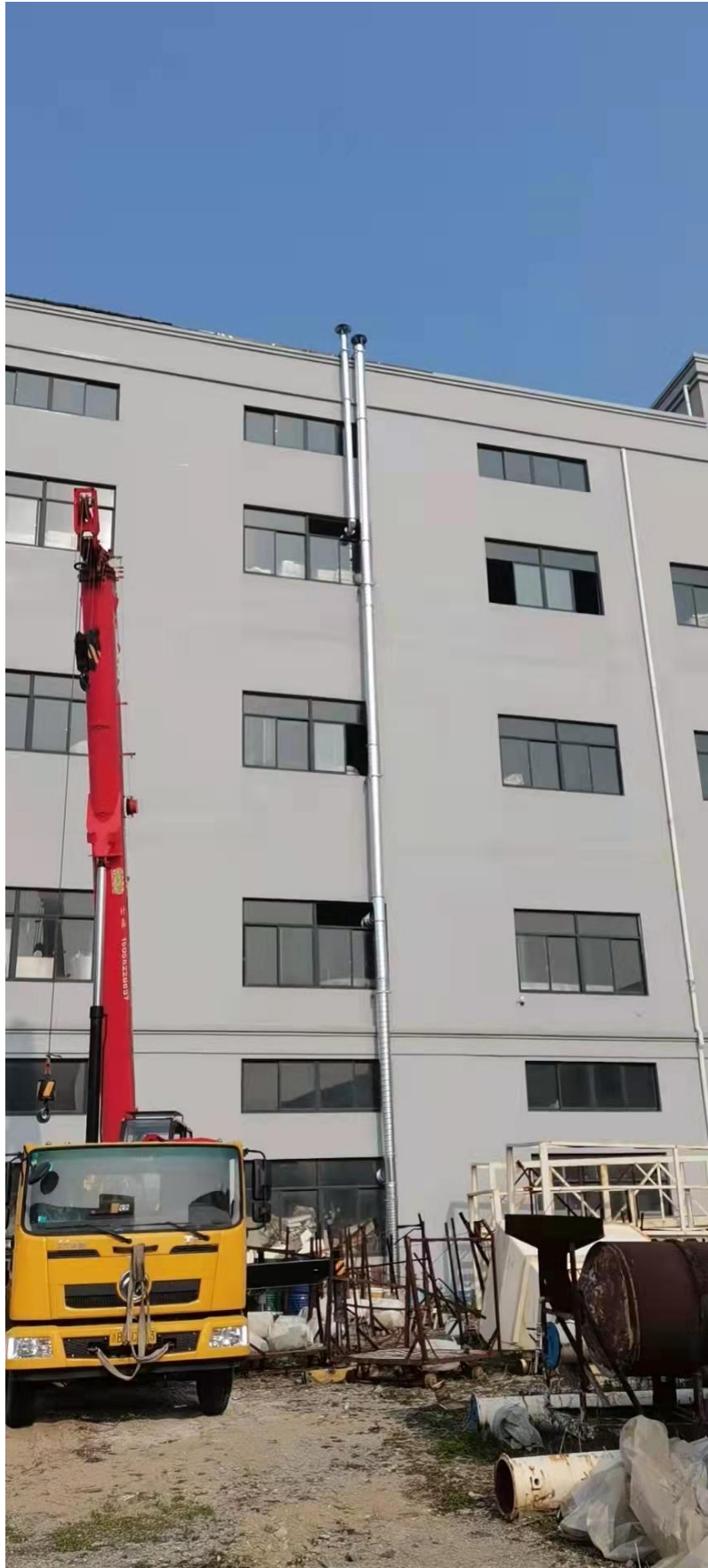
废气处理设备照片
