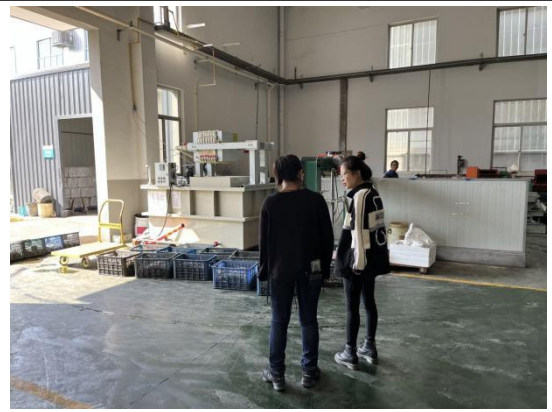
废水处理设备
