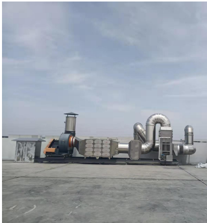
废气处理设备
