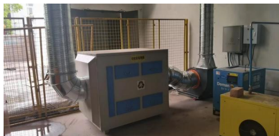
废气处理设备照片
