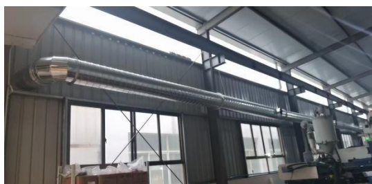
废气处理设备照片
