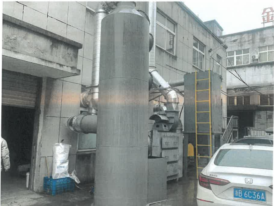
袋式除尘器及“水喷淋+纤维过滤棉（除湿）+活性炭吸附”处理装置
