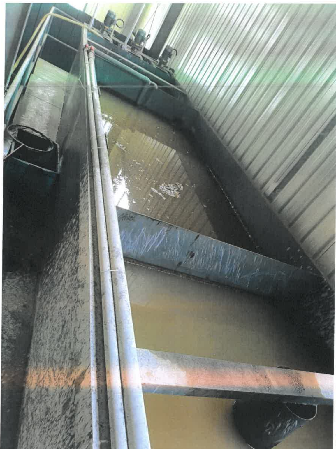
废水处理设施
