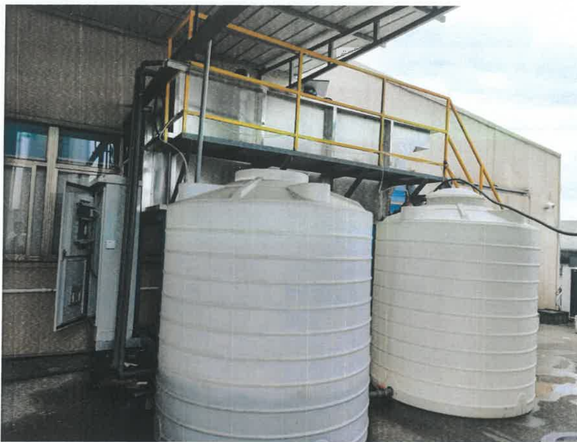
预处理设备（隔油+混凝沉淀）
