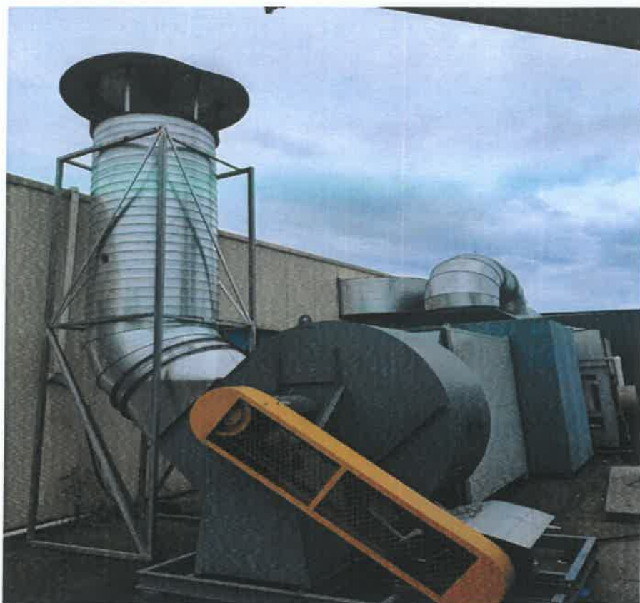
喷塑废气排放口
