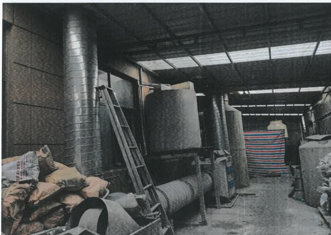
高效水喷淋+活性炭设备
